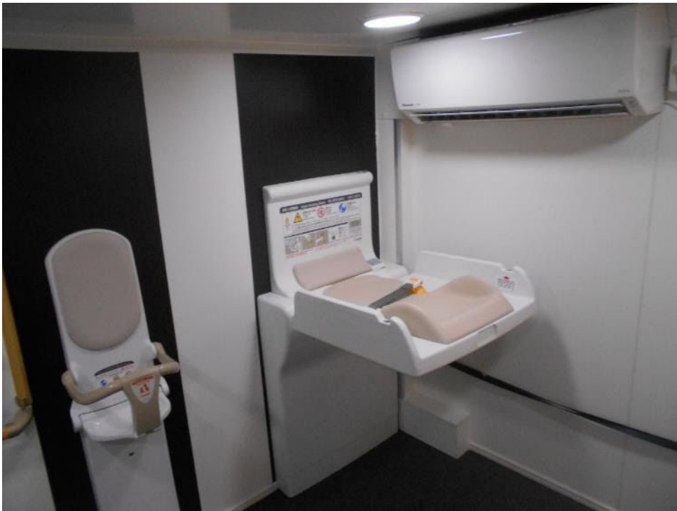
写真5 ユニバーサルトイレカー内部2
